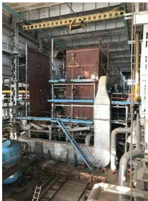
Трубная система нового котла
